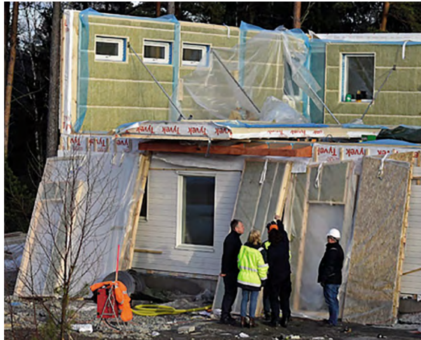
En lettisk byggnadsarbetare i 50-årsåldern dog på ett bygge i Åkersberga, norr
